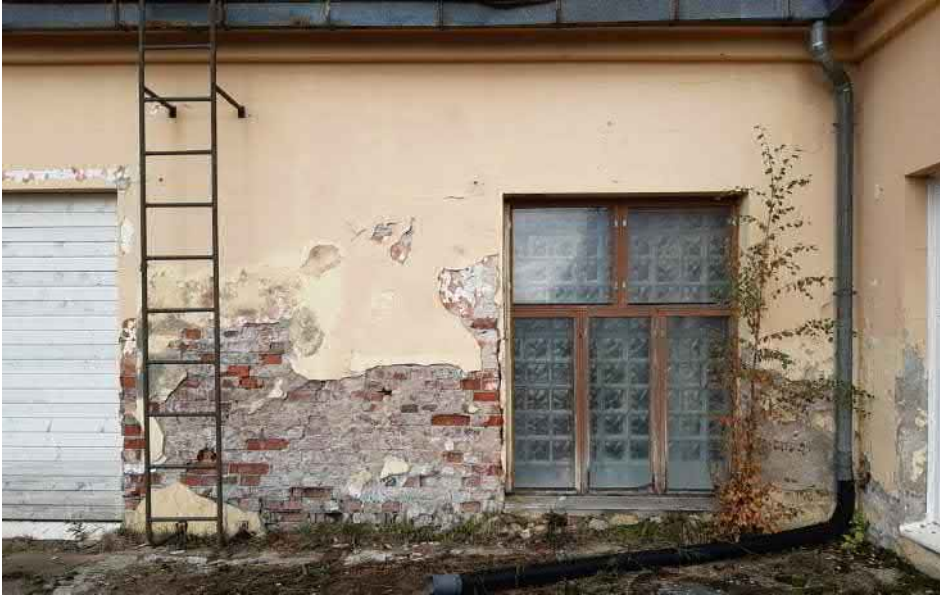
Kuva 45. Meijerisalin alkuperäinen ikkuna on vuorattu sisäpuolelta lasitiilillä. Rapautuneen julkisivun takaa on paljastunut punatiilinen seinärakenne.
