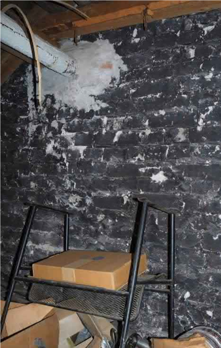
Kuva 63. Entisen pesukeskuksen yläpuolella ullakolla on nähtävissä vuoden 1934 tulipalon jälkiä tiiliseinässä.
