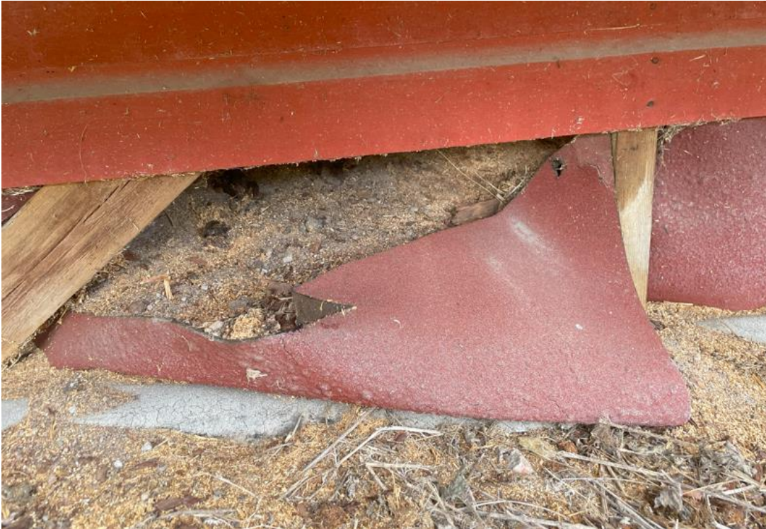
Kuva 11. Bitumikermisuikaleet käpertyneet. Yläpohjan sahanpurueriste näkyvissä.
