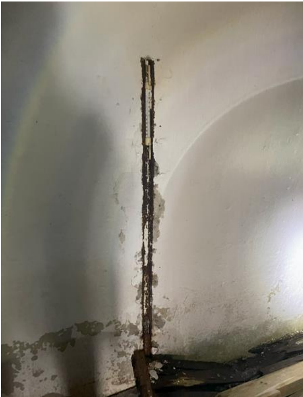
Kuva 25. Seinässä ruosteisia teräksiä. Seinä märkä alaosasta.
