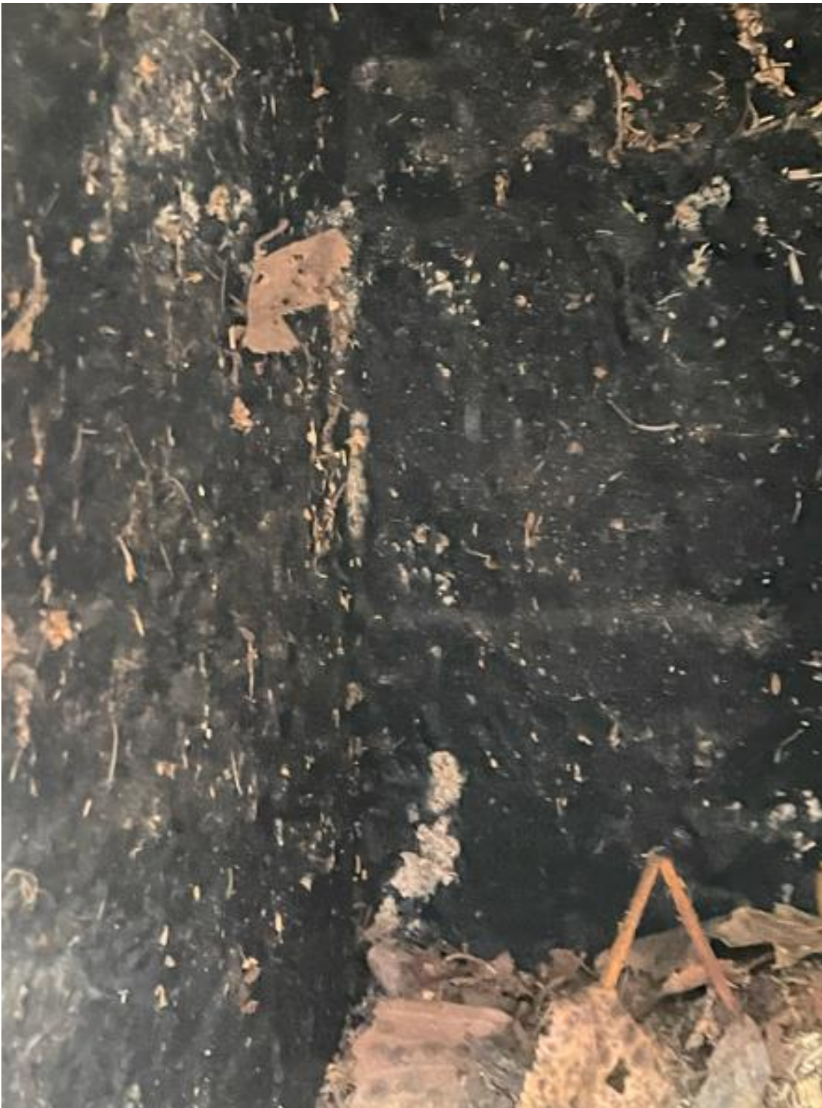
Kuva 6. Eteiskäytävän maataytön puoleisen seinärakenteen pikikäsittely. Käsittely ei enää ole kosteutta eristävä.
