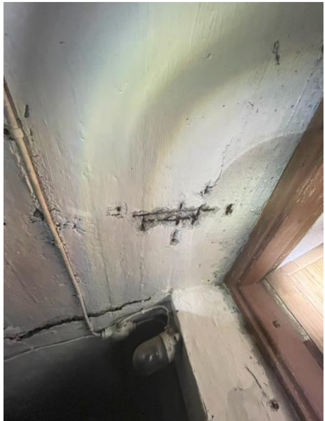
Kuva 26. Katon ruosteista teräsverkkoa.
