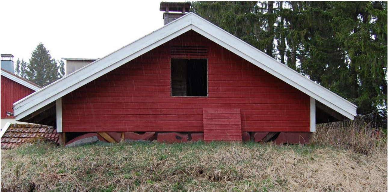
Kuva 9. Bitumikermisuikaleet käpertyneet. Yläpohjan sahanpuruesiteen päälle pääsee lunta ja sadetta.
