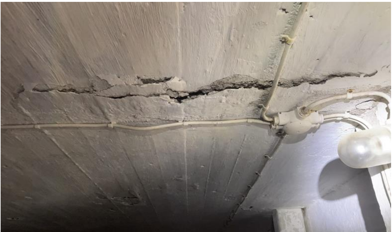
Kuva 27. Katon ruosteisia teräksiä, jotka murtavat suojabetoni
