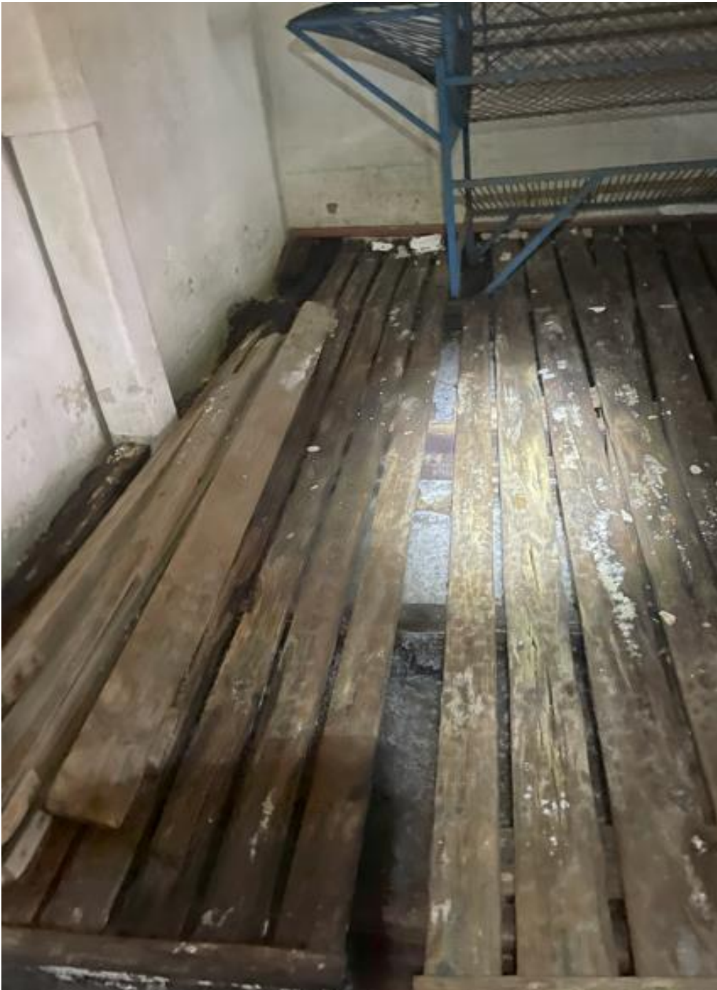
Kuva 5. Maakellarin lattian niskojen päälle asennetun harvalaudituksen alta näkyy lattia, joka on kostea ja homekasvuston peitossa.
