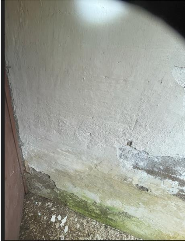
Kuva 29. Rapattu seinä murtunut.
